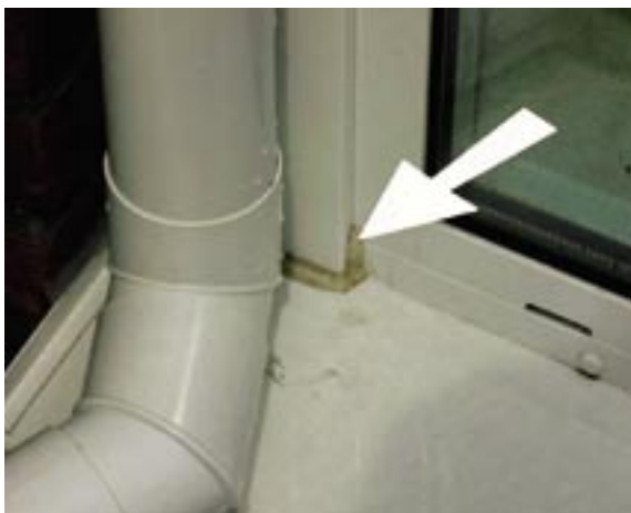
Bild 2: „Silikon“ an dieser Stelle stört die Optik empfindlich und ist sinnlos, da die wasserführenden Profilebenen tiefer liegen
